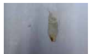
Un rinçage à l'eau avec frottement ne permet pas d'éliminer ces traces. L'acier inoxydable est corrodé.
